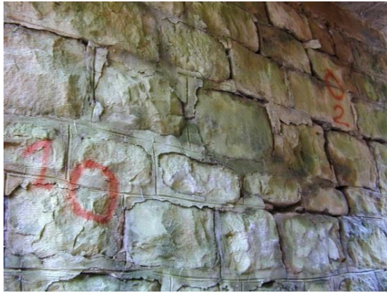
Foto 13: Fugen systematisch abgerissen
