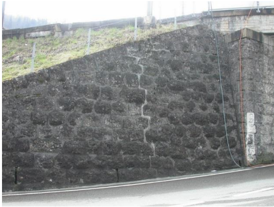
Foto 9: vermutete leichte Verformung, vermörtelter Riss als Indikator
