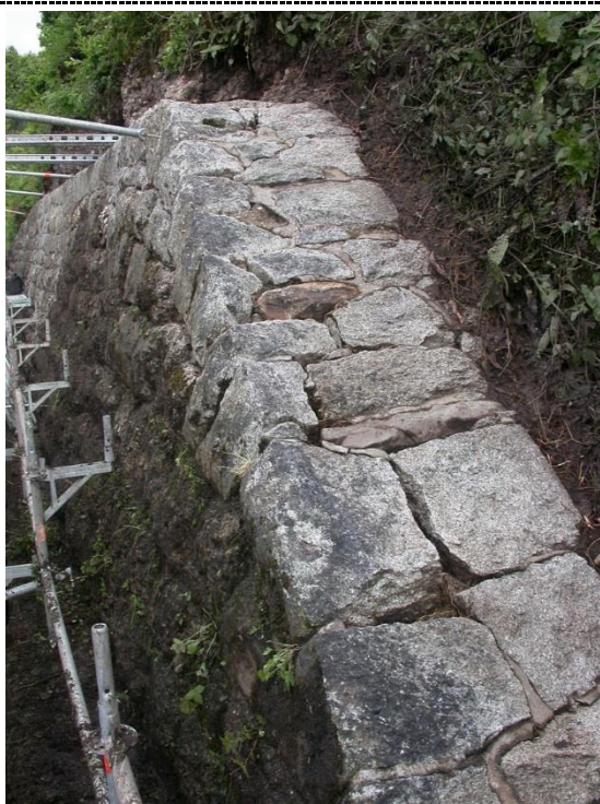
Foto 15: Mauerkrone mit ausgewitterten Fugen
