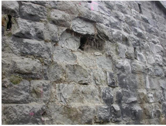
Foto 23: tief verwitterter Sandstein, vollflächig (meist nur durch Abklopfen erkennbar)
