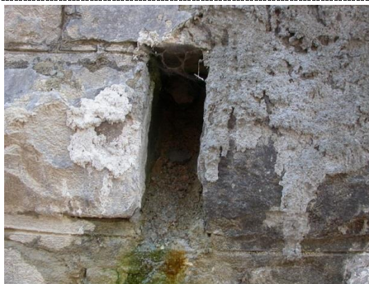
Foto 4: Mörtelschutt in Entlastungsöffnung
