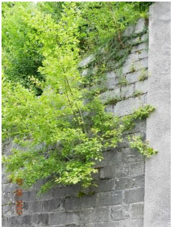
Foto 7: starker, verholzender Bewuchs (mit Schadenfolge)
