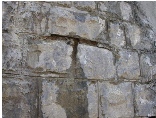
Foto 2: örtlich drückendes Wasser
